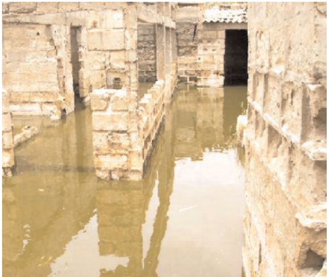
Figure 8: Maisons abandonnées à cause des inondations. Photo ISE (ISE 2005) Source : Rapport GEO ville de Dakar
